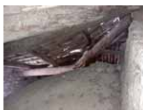
poutre avant restauration
