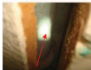
Composant : Conduit de fluide (eau) Un conduit vertical encoffré et un conduit horizontal Dégagement escalier et salle 1 (au plafond)
