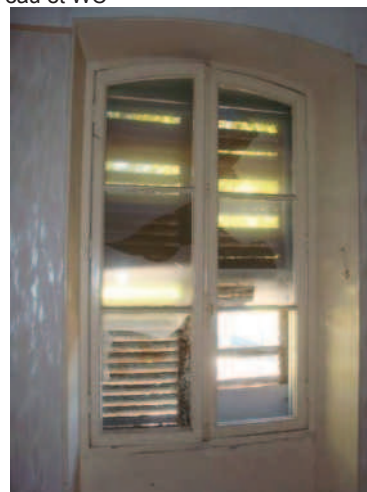
Composant : Joints de panneaux (cloisons, gaines) Mastic vitrier Menuiseries 1er étage
