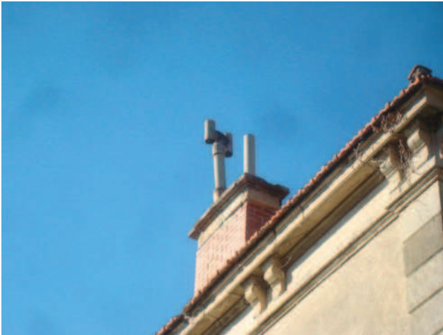
Composant : Conduit de fluide (air) deux conduits en toiture dont un avec chapeau type H marine Toiture
