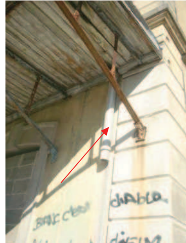
Composant : Conduit de fluide (eau) Descente eau pluviale Façade auvent en partie basse
